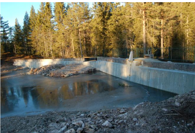
Bilde 5 Dam Solbergvann etter rehabilitering, Magasinet er ikke helt oppe på rett vannstand ennå.
