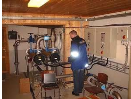
UV-aggregatene ved Sylling vannverk Kilde for foto: http://www.glitre.no
